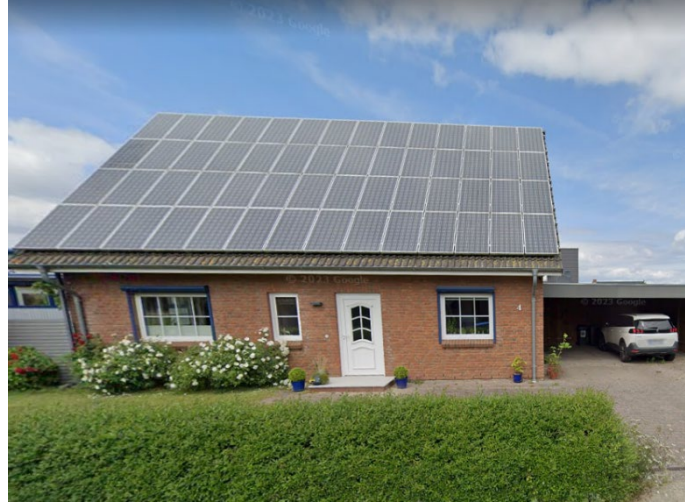
Abbildung 15: Photovoltaik-Anlage im Quartier (Quelle: Google Street View, 2023).
